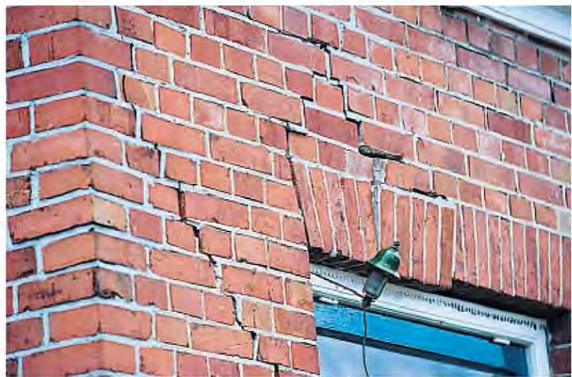
In de bakstenen gevel zitten grote scheuren.
